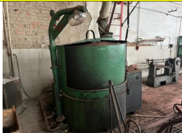
Оборудование котельной транспортного цеха
